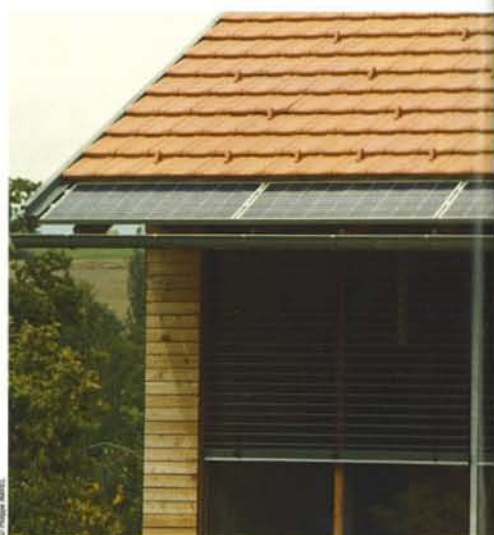
▲ En bordure de toiture, on peut voir les cellules photovoltaïques dont l'électricité produite est revendue à EDF.
