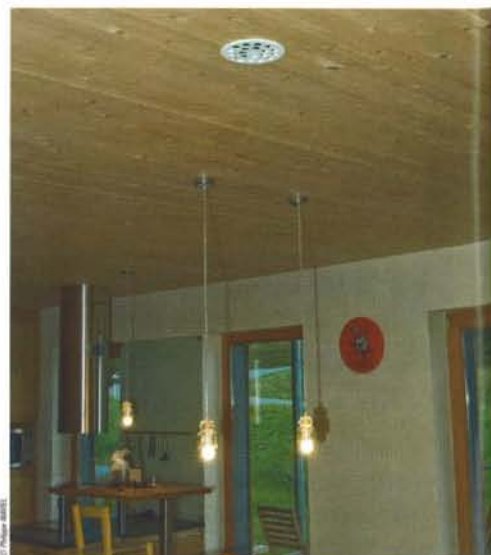
▲ Au centre du plafond, on voit une des bouches de renouvellement de l'air.
